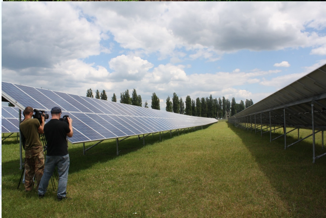
Сонячна станція в с. Ясенівка, потужність 500 кВт.
