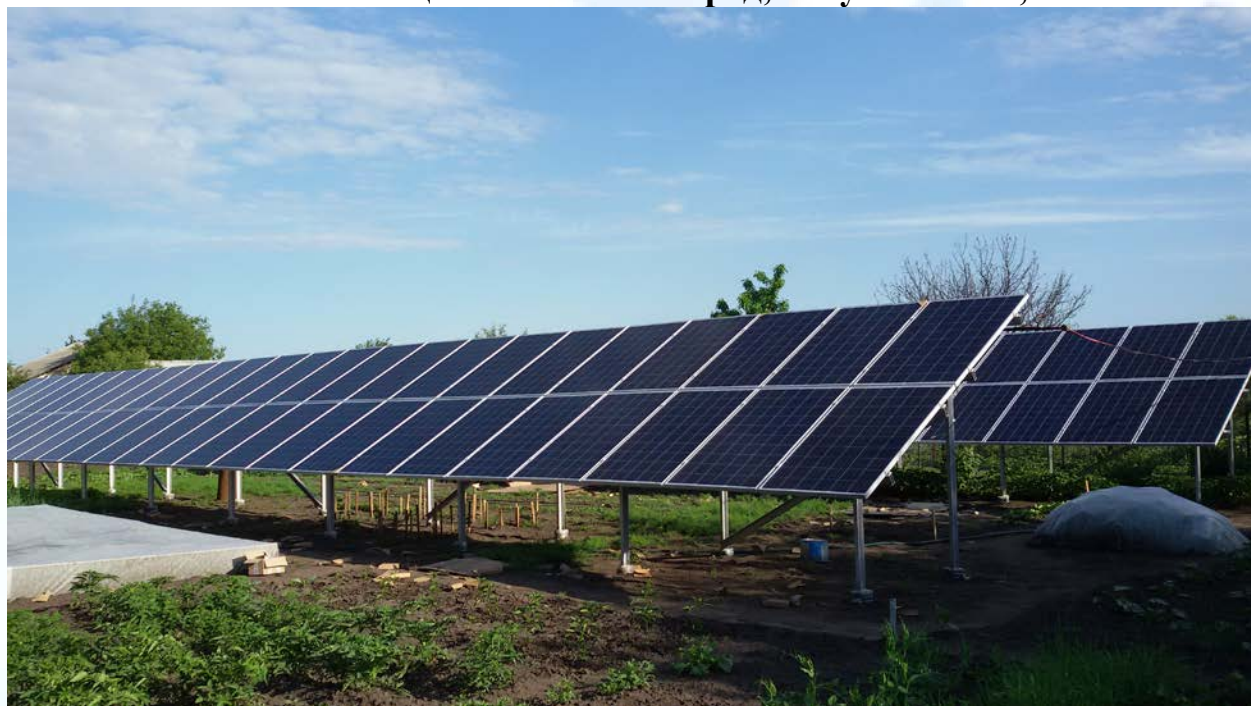
Сонячна станція в смт. Павлоград, потужність 30,2 кВт
